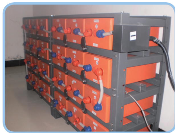
台州移动基站
