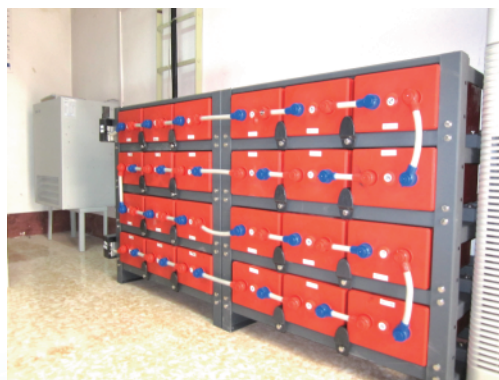
某电信公司高温电池应用
