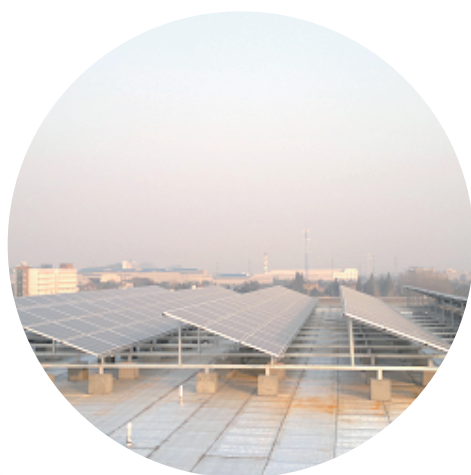
南都电源0.5MW光伏系统
